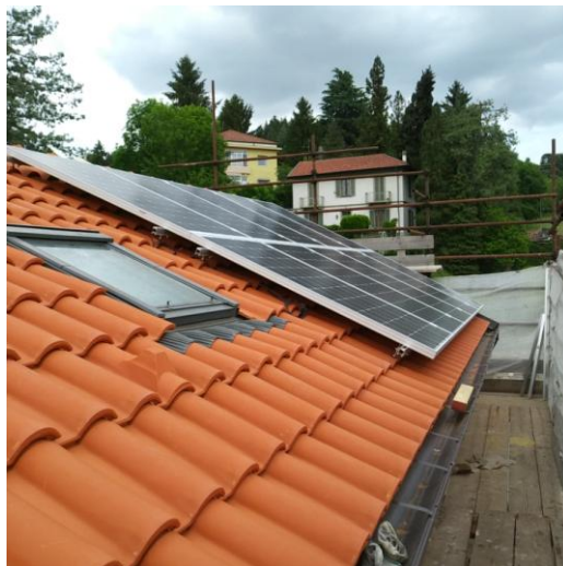
Figura 2 Vista d'insieme dell'impianto installato
