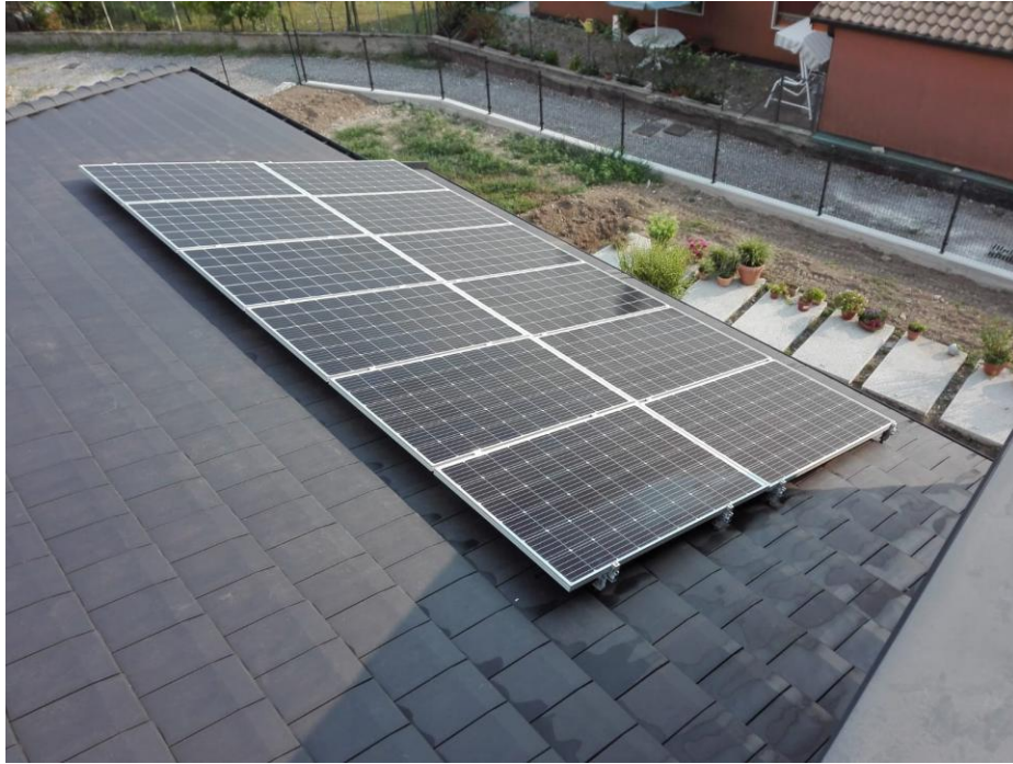
Figura 3 Vista d'insieme dell'impianto installato
