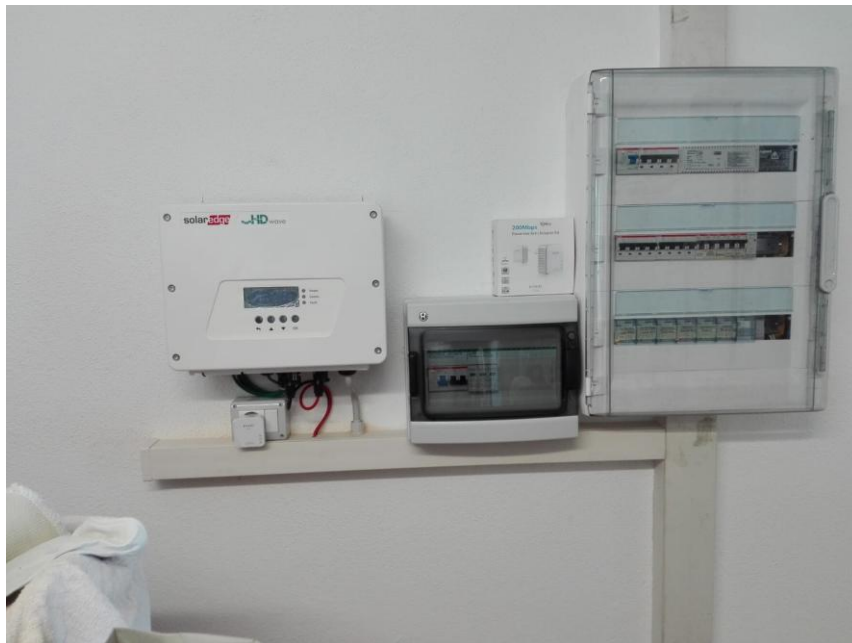
Figura 1 Particolare dell'inverter e del quadro elettrico.
