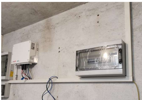
Foto 4. Inverter Solaredge e quadro elettrico
