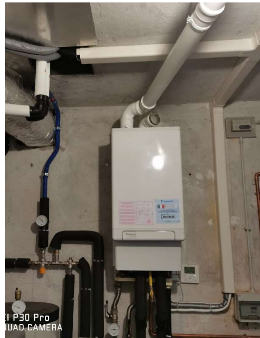
Foto 2. Caldaia a condensazione
