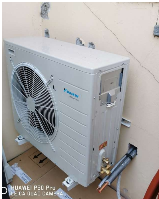
Foto 1. Macchina esterna pompa di calore Hybrid
