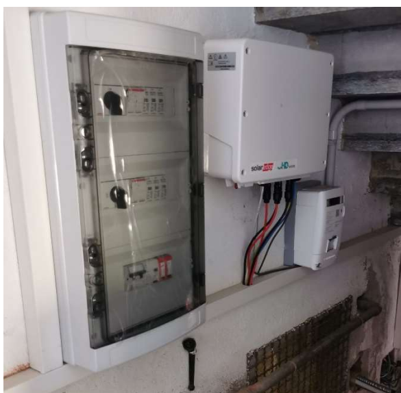
Foto 5. Quadro elettrico e inverter Solaredge
