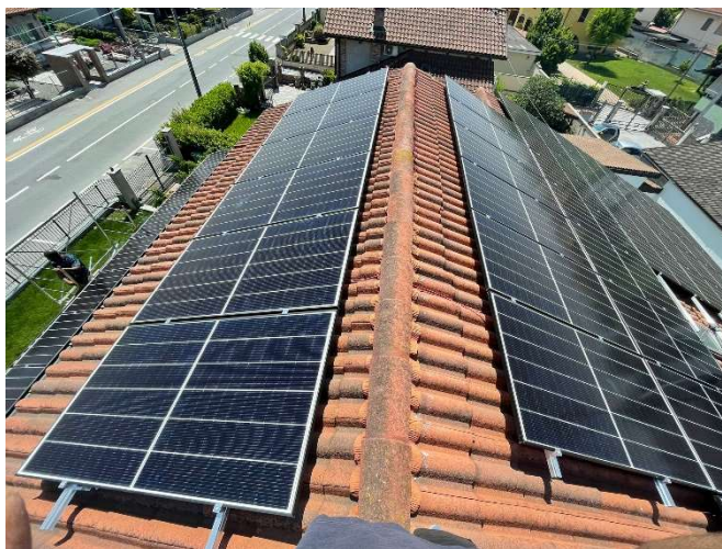
Foto 2. Impianto fotovoltaico terminato
