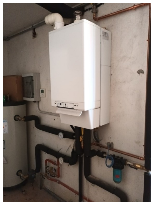
Foto 1-2. Impianto termico ibrido
