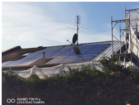
Foto 3. Impianto fotovoltaico terminato
