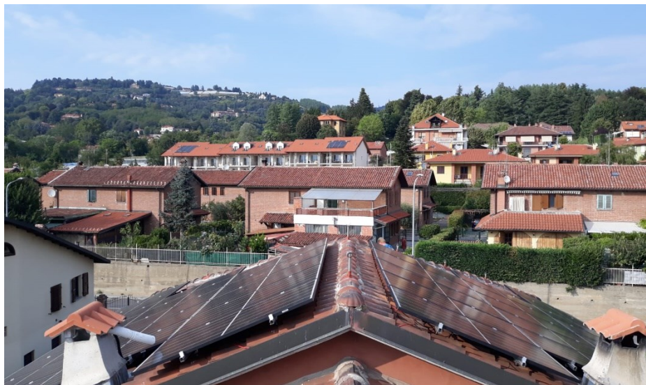
Foto 3. Impianto fotovoltaico terminato
