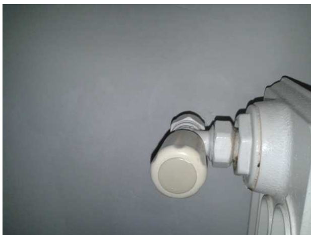
Valvola prima dell'intervento
