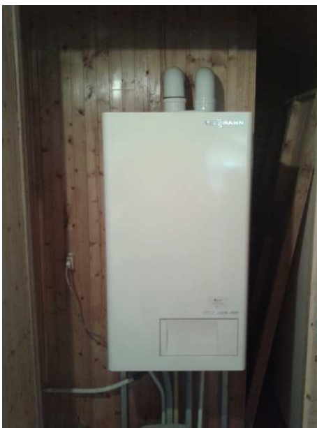
Vecchia caldaia a condensazione VIESSMANN
