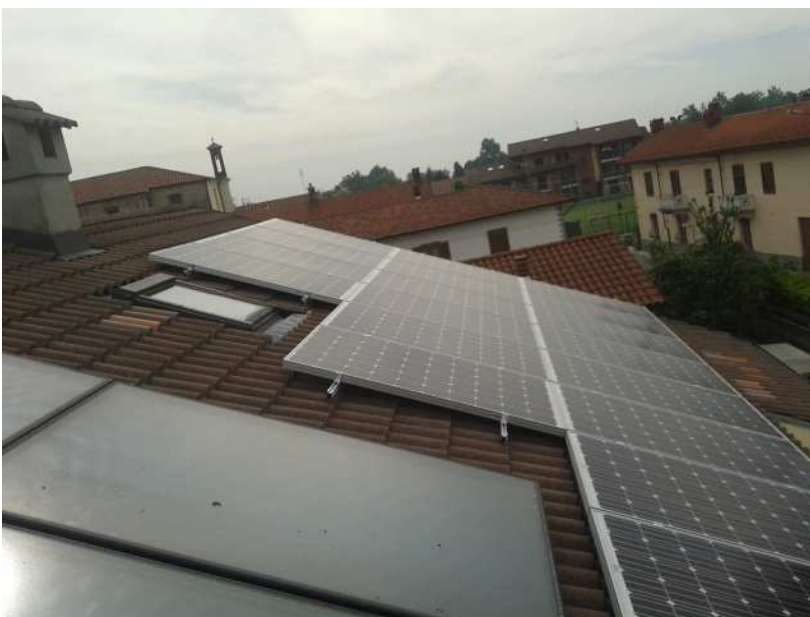
Impianto Solare Termico e Fotovoltaico
