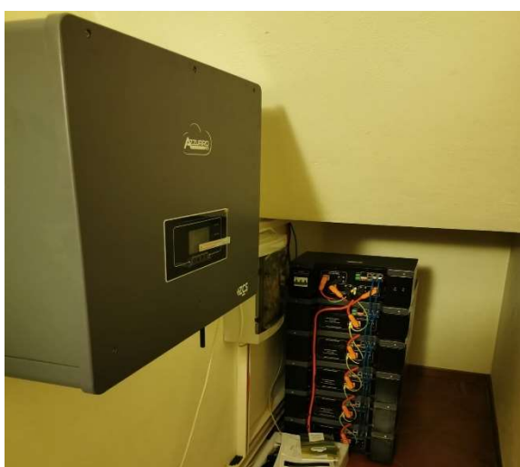
Foto 6. Inverter ZCS e batterie WECO
