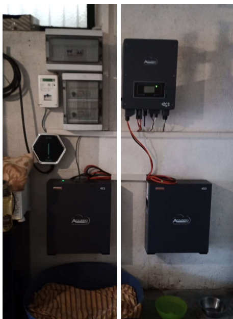
Foto 3. Inverter Zucchetti ,sistema di accumulo WECO e colonnina di ricarica per veicoli elettrici
