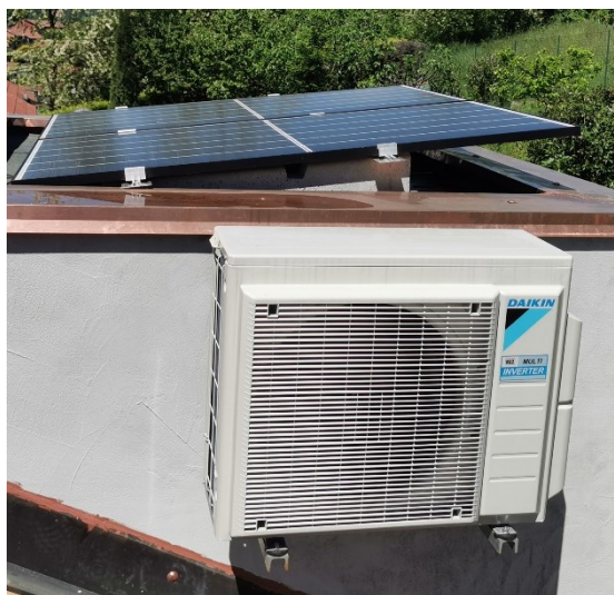
Foto 1. Macchina esterna pompa di calore Hybrid
