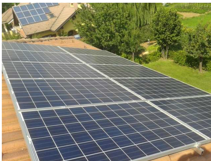
Energia elettrica prodotta dall'impianto fotovoltaico installato a Bruino
