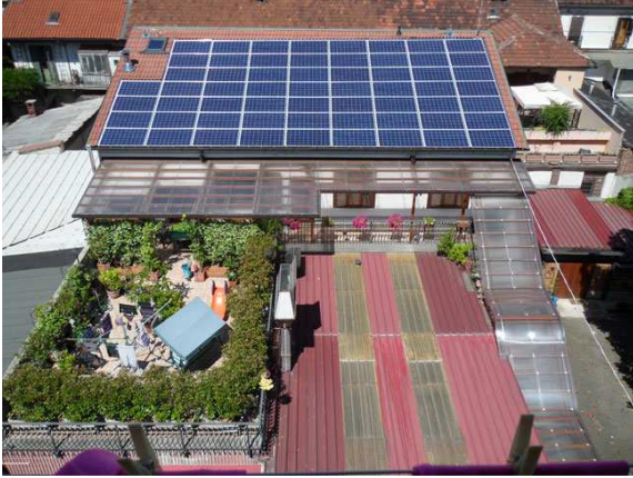
Nuovo impianto fotovoltaico installato.
